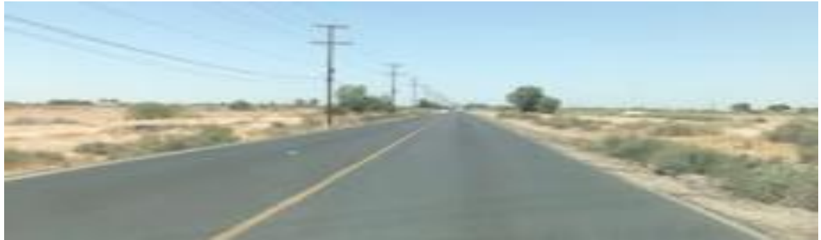
Figura 22.- Condiciones de la Carretera Progreso -Santa Isabel Fuente. - Elaboración propia
